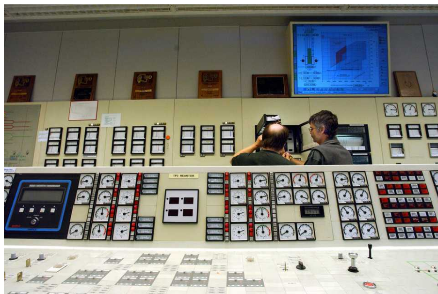
Зал управления АЭС в Мюлеберге ©Keystone
