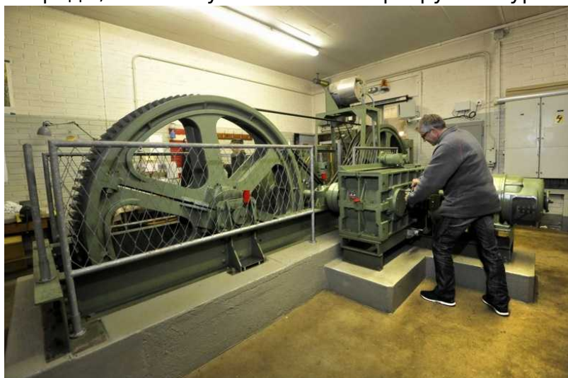
Зал управления фуникулером (lenouvelliste.ch)
